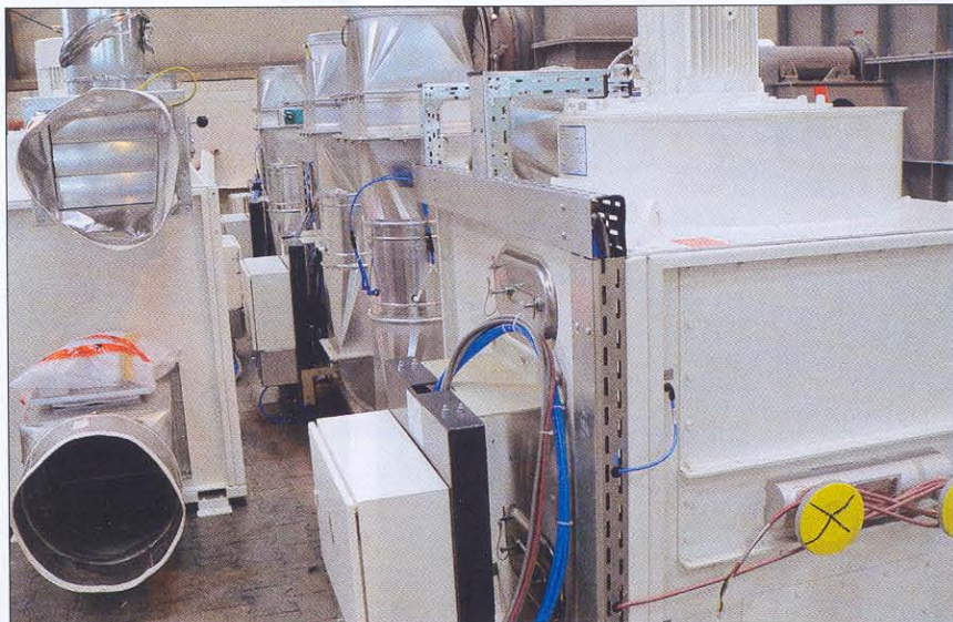
Lufttechnik für eine Druckmaschine (auf MDF/HDF)
