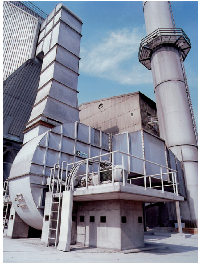
Bild 7: Abgasventilator hinter Elektrofilter
