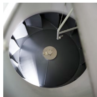
Wassereindüsung zur Vermeidung/ Reduzierung von Anbackungen
