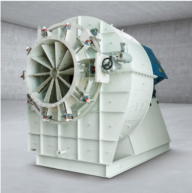
Ventilator hinter Wäscher in einer Calcium-Ammoniumnitrat-Anlage
