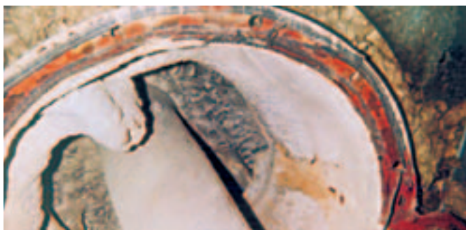
Anlagengefährdende Anbackungen durch den Transport staubbeladener Gase
