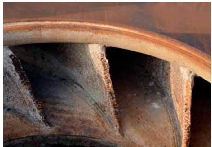
b) Auswaschung an Lüfterschaufeln
