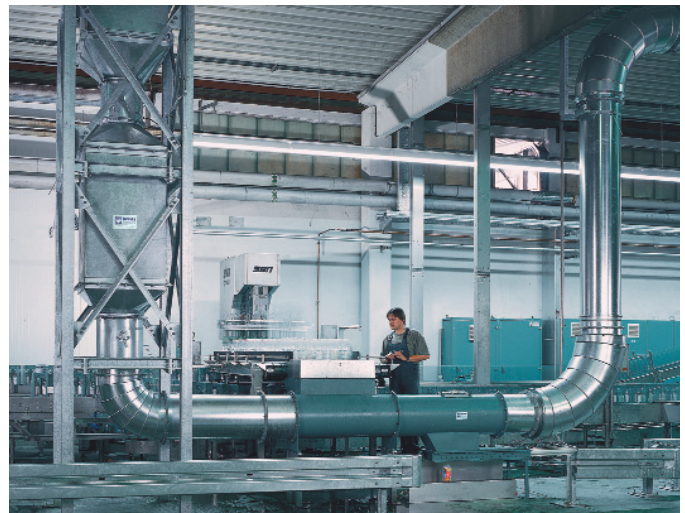
Aufgabestation mit Zuluftanlage und Förderrohrleitung
