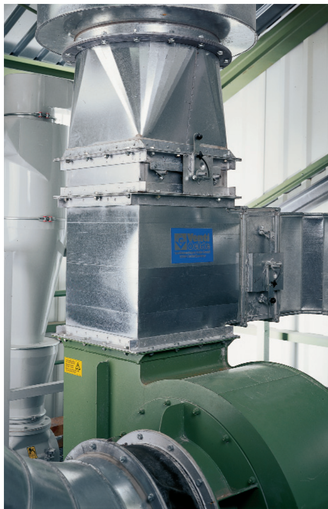
Radialventilator mit Umschaltung für Rück- oder Abluft
