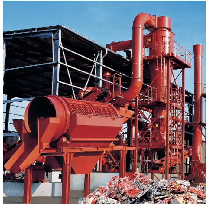
Peripherieanlage hinter MMS-Shredder
