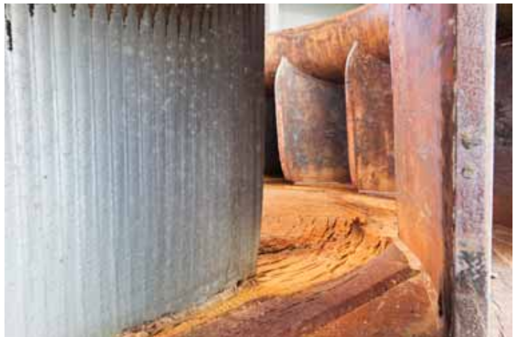
Laufrad mit Verschleiß an der Mittelscheibe
